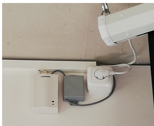
Abbildung 5: Selbstgedruckte Box mit Relais zur Steuerung der Leinwand
